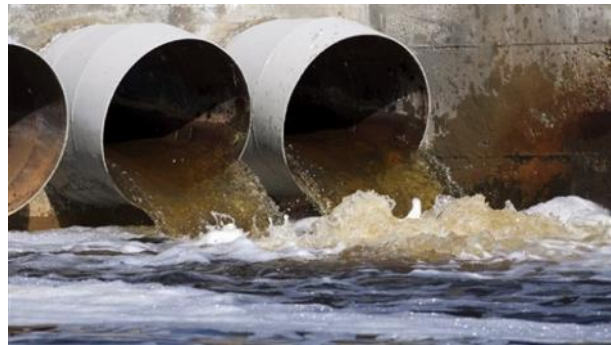
Rejet d'eaux usées © iStock
